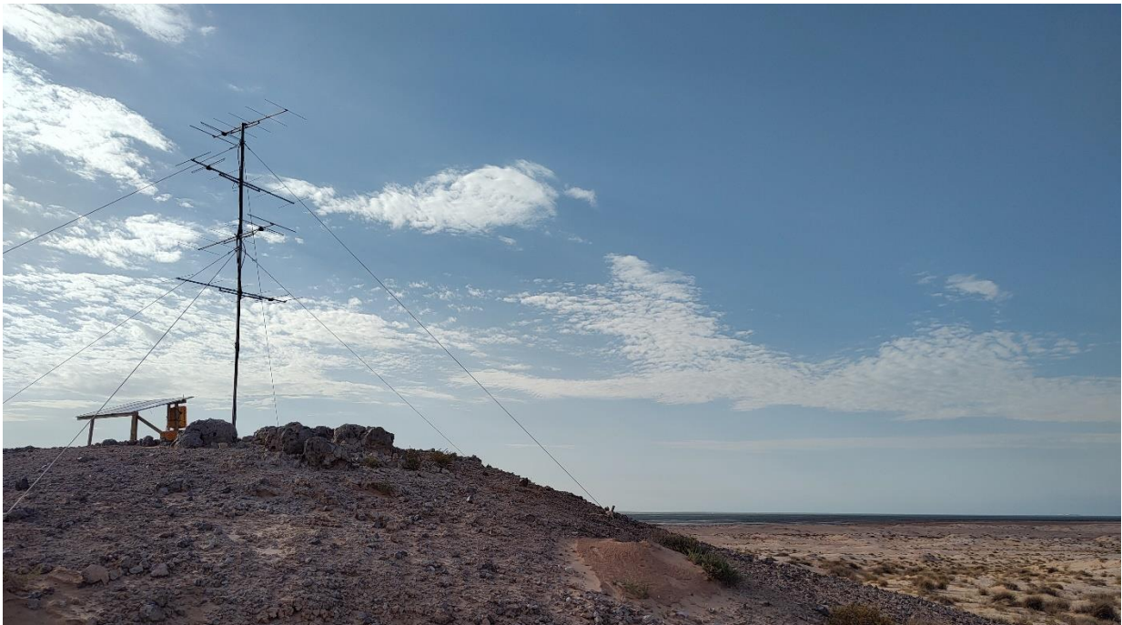
Figure 13. La station de réception alimenter en électricité grâce à des panneaux solaires et une batterie de 12V. Photo par Jan van Gils
